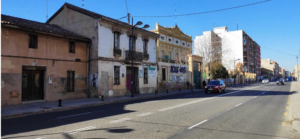
Foto 11. Línea eléctrica aérea en cruce de calle San Vicente Mártir
