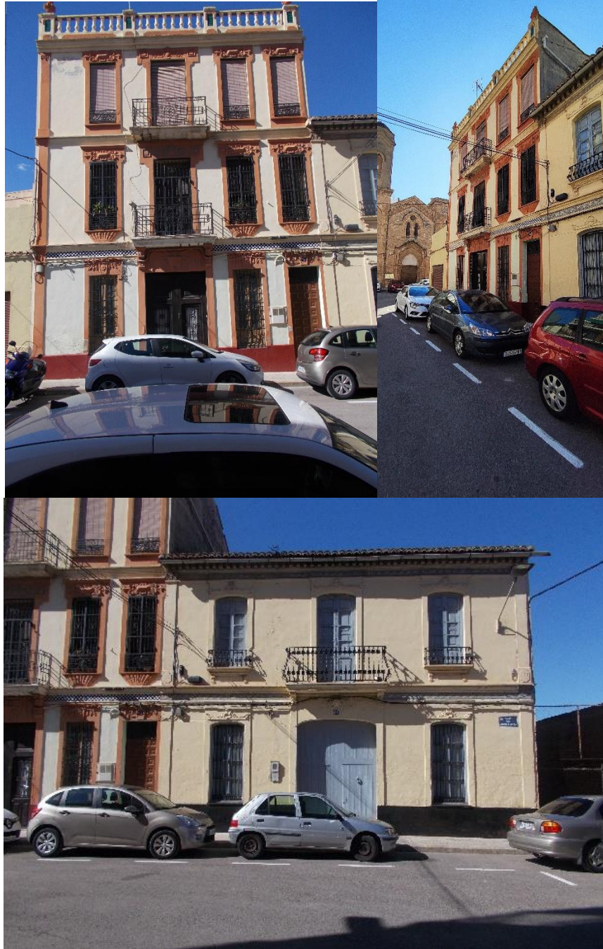
Fotos 8. Cableado por fachadas en Plaza Vicario Ferrer e inicio de línea aérea.
