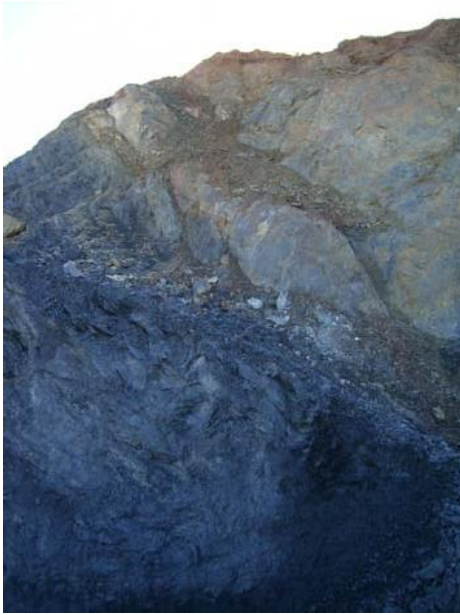
Imagen nº 42: Surgencia de agua en talud de desmonte
