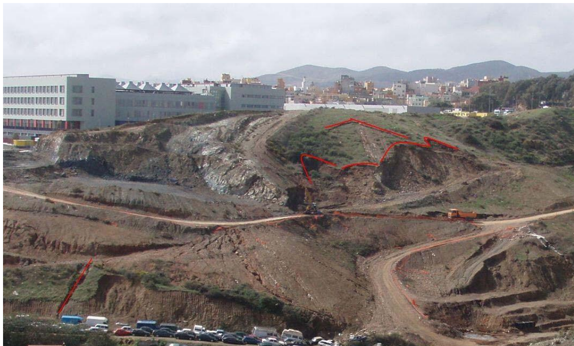
Imagen nº 37: Aspecto general de deslizamientos de ladera afectando a materiales coluviales.
