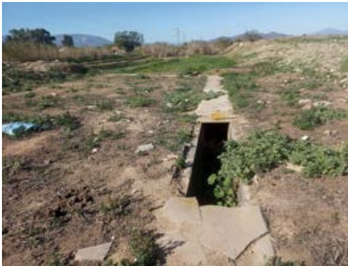
Ilustración 5: Imagen de canalización con relleno de escombros.
