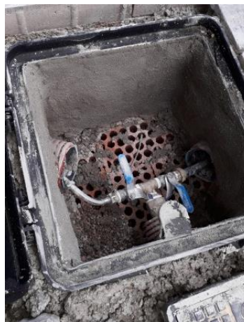
Detalle de la "T" con la válvula ½ "de la fuente y del drenaje
