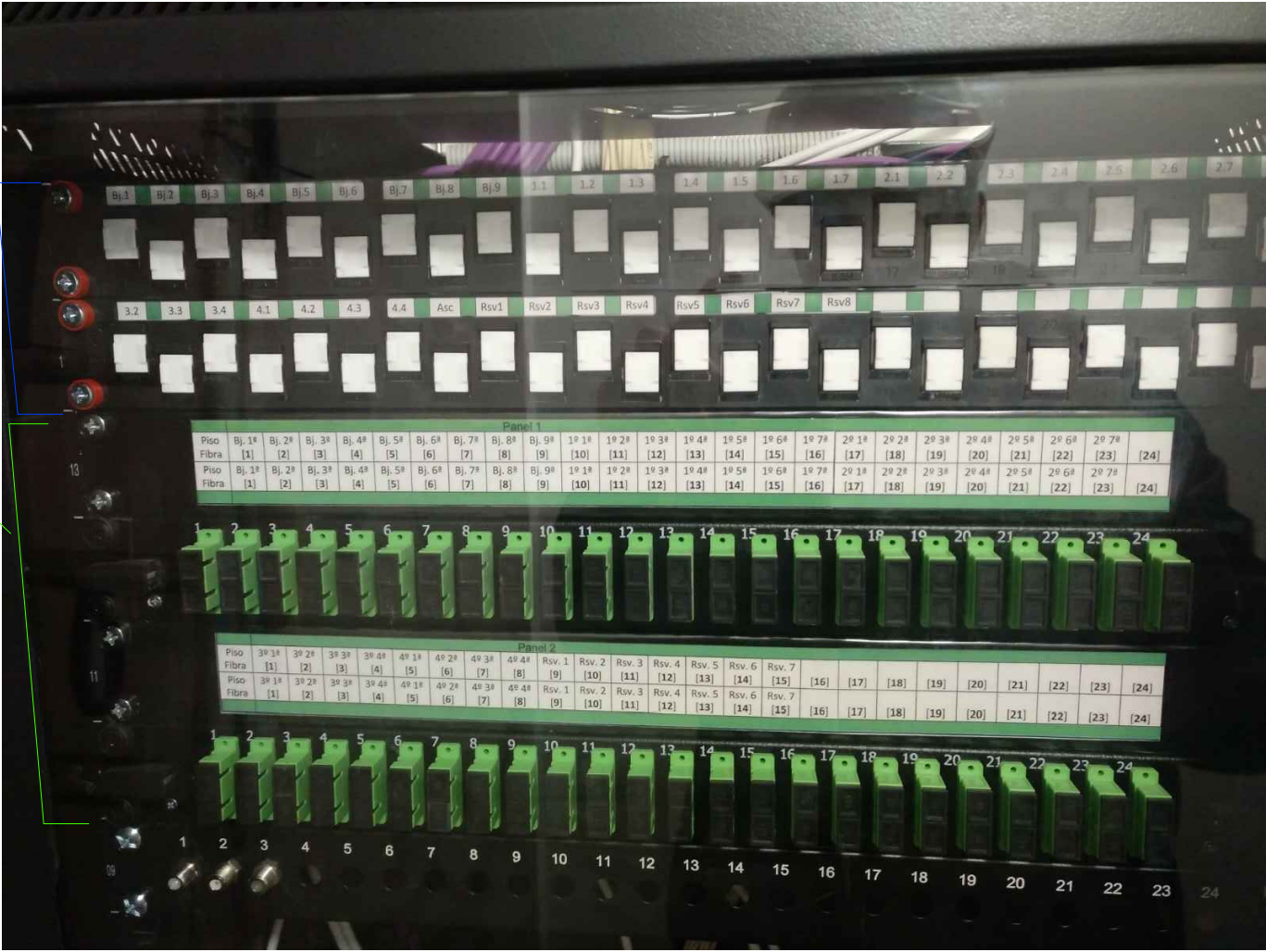
Fotografía de ejemplo del rack de 12U a instalar con los paneles de pares trenzados y fibra óptica.
